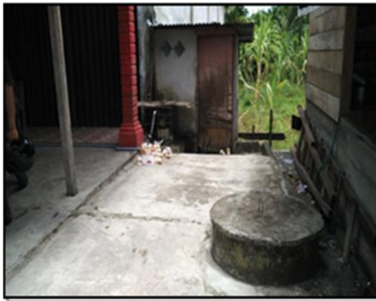
Gambar 1. Kondisi tidak sehat dimana WC berada dekat dengan Sumur.
