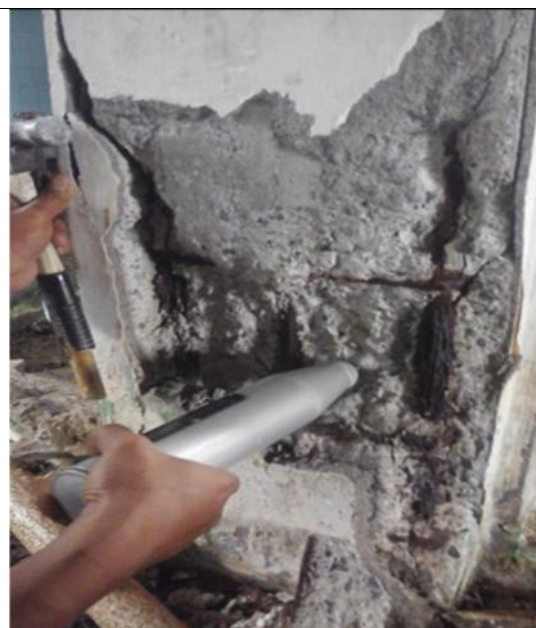
Gambar 3: Kondisi tulangan setelah pembobokan Sumber : Penulis
