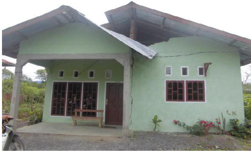
Gambar 3 Rumah Rusak sedang
