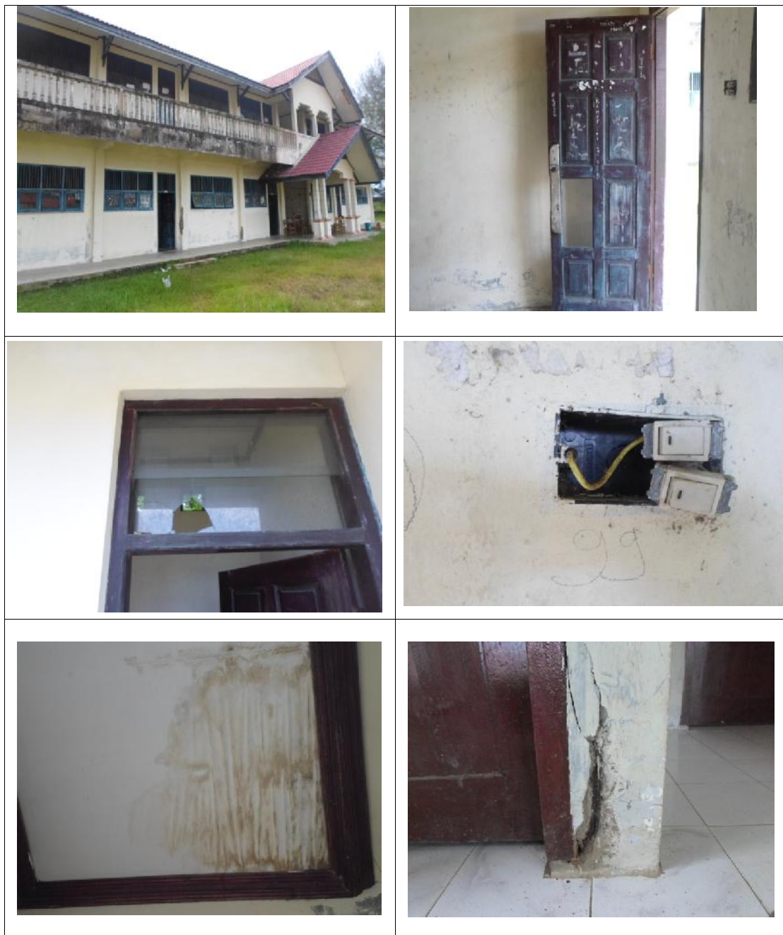
Gambar 1 Situasi Kerusakan pada SMA Bina Generasi Bangsa Meulaboh
