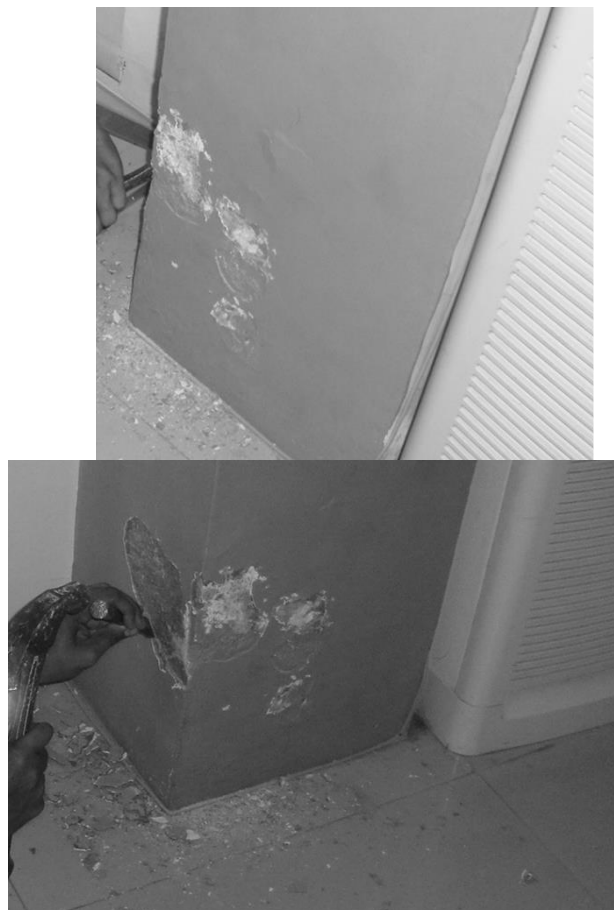
Gambar 7. Kondisi kolom mengalami pengapuran
