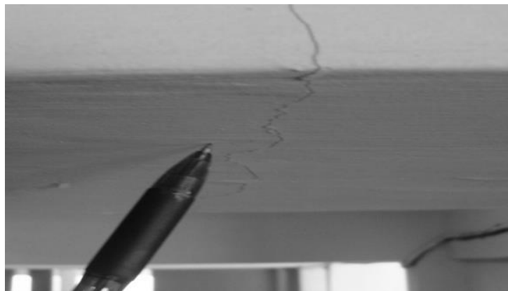
Gambar 6. Retak lentur pada balok
