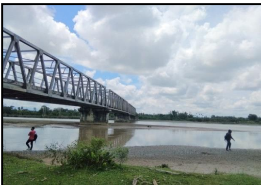
Gambar 5. Kondisi Gerusan Lokal Disekitar Pilar Jembatan
