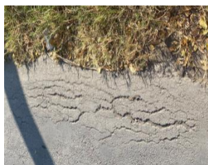
a) Jalan Retak
