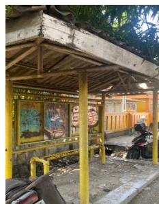
b) Kerusakan Halte
