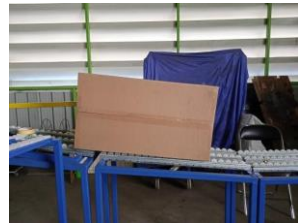
(g) Conveyor Miring Tahap Lanjutan Menuju Area Pengambilan
