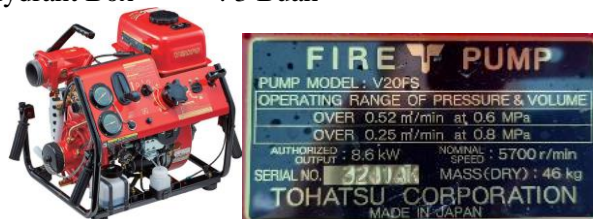
Gambar 2. Pompa Hydrant GI Aimas dan Name Plate Pompa
