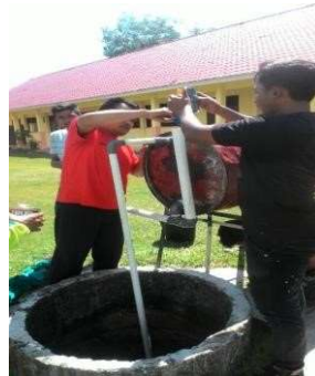
Gambar 15. Pengujian pompa vakum dan pompa hidram
