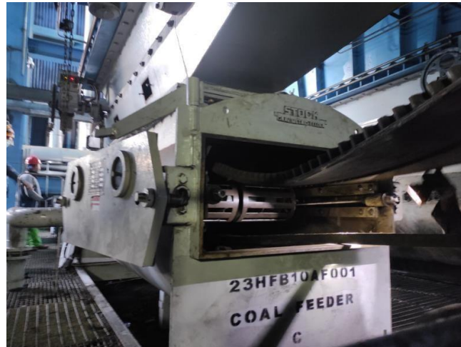
Gambar 3. Coal Feeder PLN UPK Nagan Raya)
