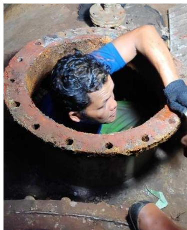
Gambar 11. Manhole Debris Filter telah dibuka
